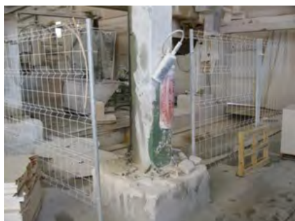
Imagen 5. Ejemplo de cierre perimetral (incorrecto)
